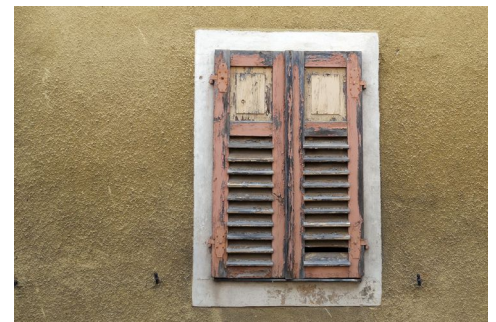
Die handwerkliche und gestalterische Qualität ist auch im sanierungsbedürftigen Zustand erkennbar
